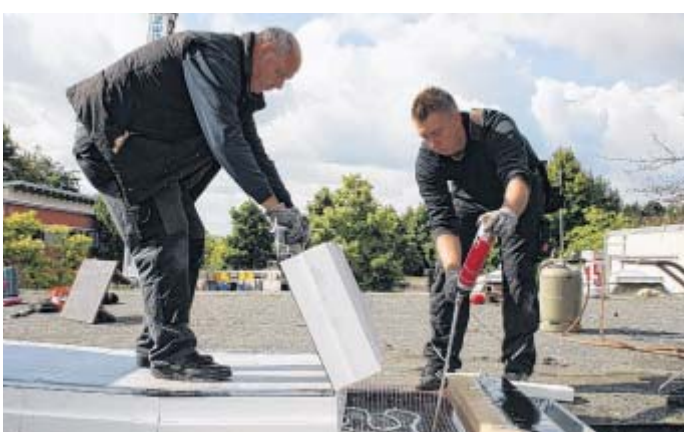
Auf dem Dach der Grundschule Nord: Die Dachdeckermeister Dieter Huiskamp (l.) und sein Sohn Christian Huiskamp verlegen die letzten Dämmplatten.
